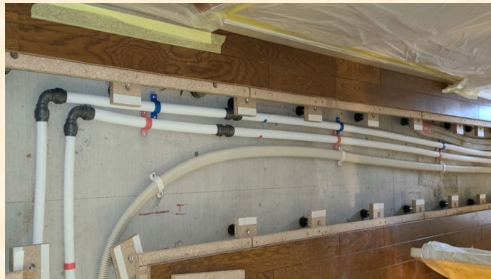
専有部給水、給湯管白色被覆管統一
