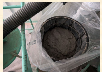
集塵装置 処理済み廃棄物
