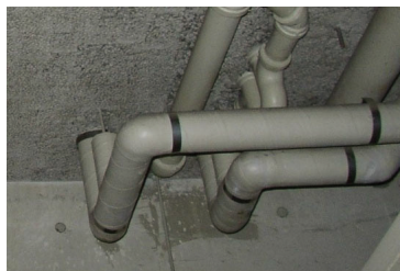
配管類の保温材
