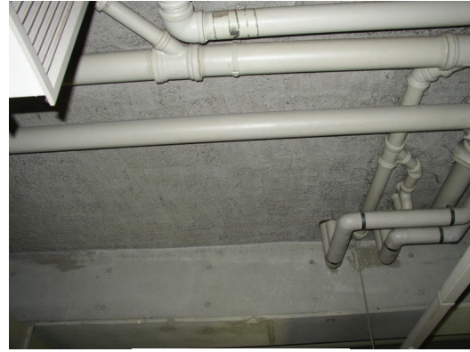
機械室の吹付材
