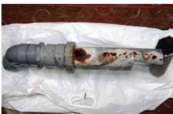
亜鉛めっき鋼管の劣化
